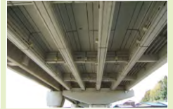
有井川橋・電気防蝕 (黒潮・国道56号)
